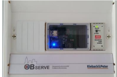
Abbildung 8.2.4-10: Demonstratormodul Fehlererkennung – Nutzungsvariante “Minischaltschrank”
